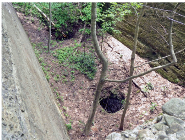
写真3 1段目構造物の西側内部と底に開いた穴
