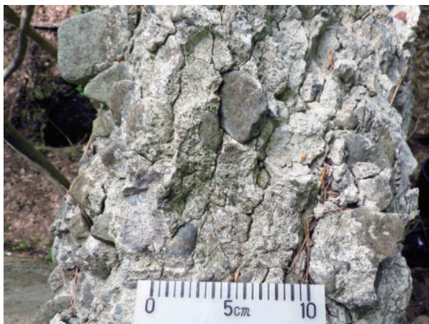
写真2 1段目構造物を造るコンクリート破断部
