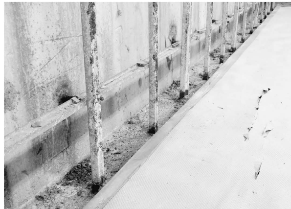
4 下地の根元の腐食がはげしい
