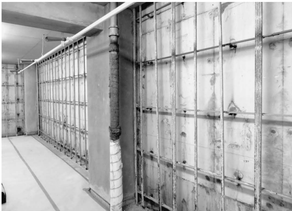
3 壁面ボード撤去。下地骨組みと断熱材の劣化を発見
